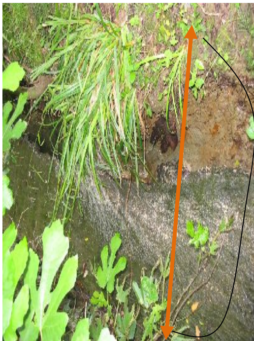
PETIT ENROCHEMENT DE REMBLAI DU LIT ET PROTECTION EN PIED DE BERGES FASCINAGE (50 METRES)
